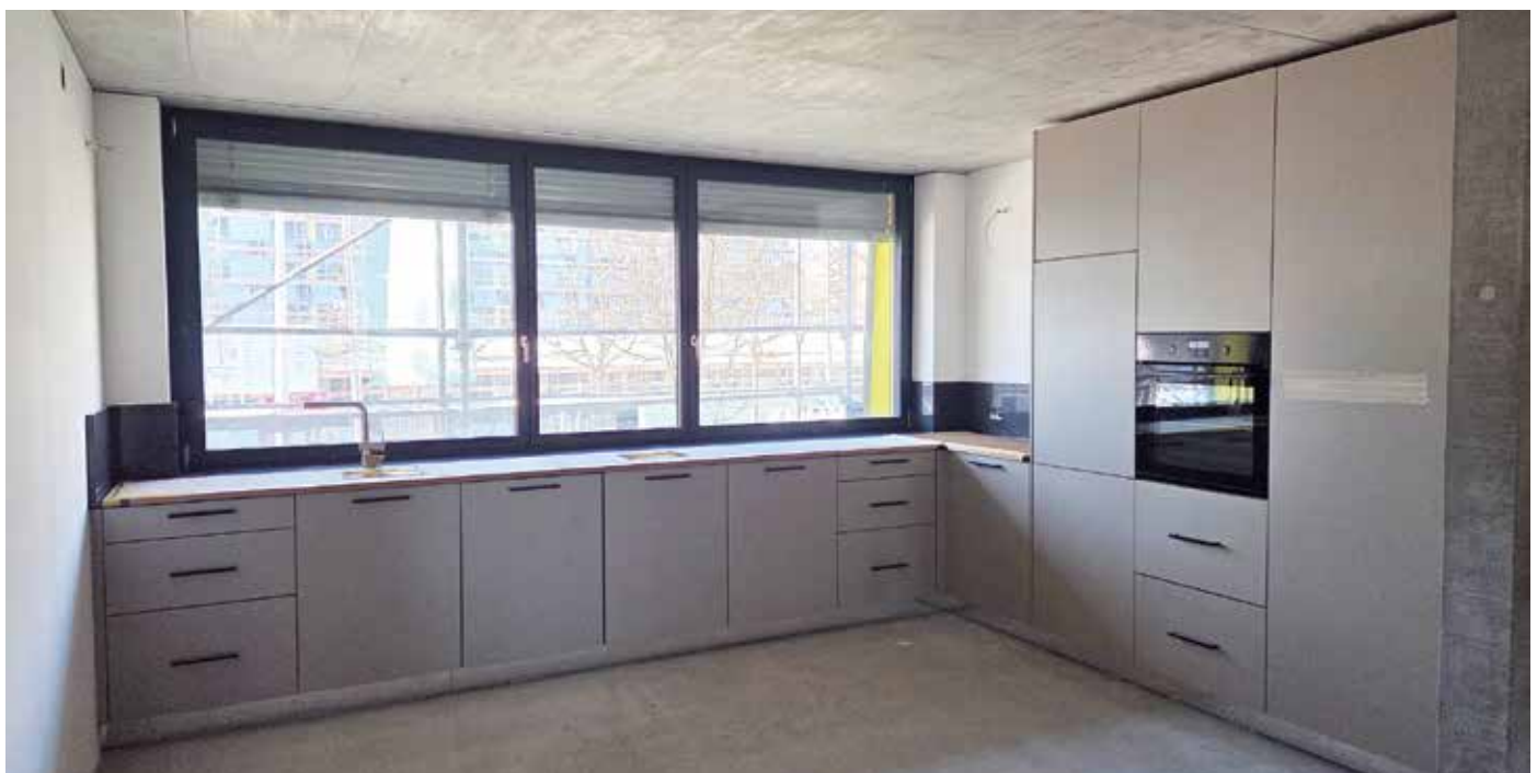
Die Innenausbauarbeiten schreiten hurtig voran. Hier der Blick in eine fast fertig gestellte Küche.
